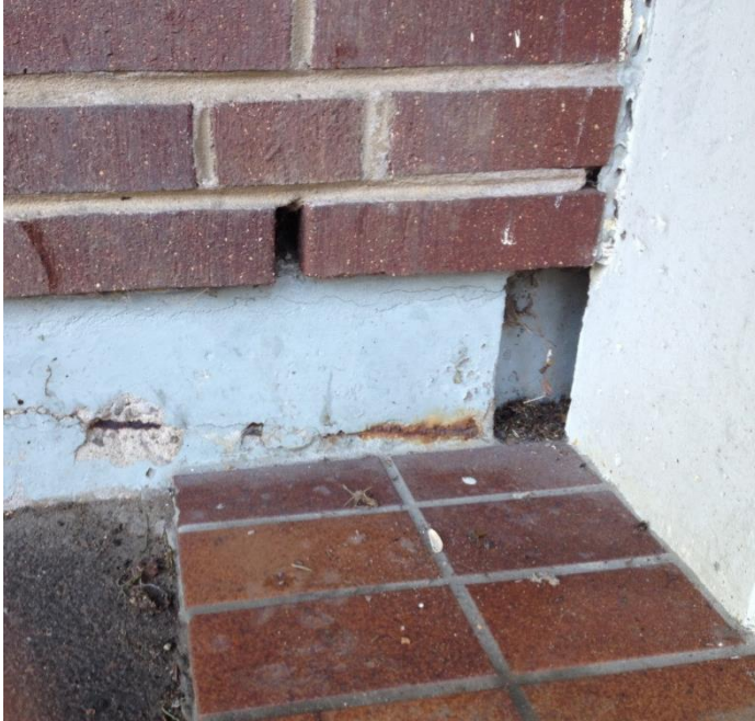
Figur 3.10: Armeringskorrosion i grundmur (Fotograf: V. Karlin).
