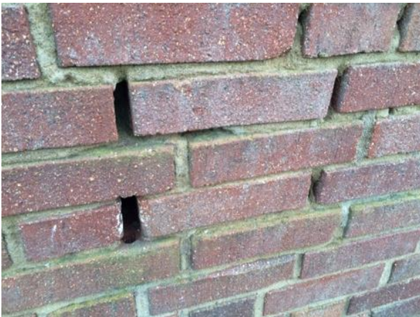
Figur 3.9: Fogar i bärande tegelvägg (Fotograf: R. Friberg).
