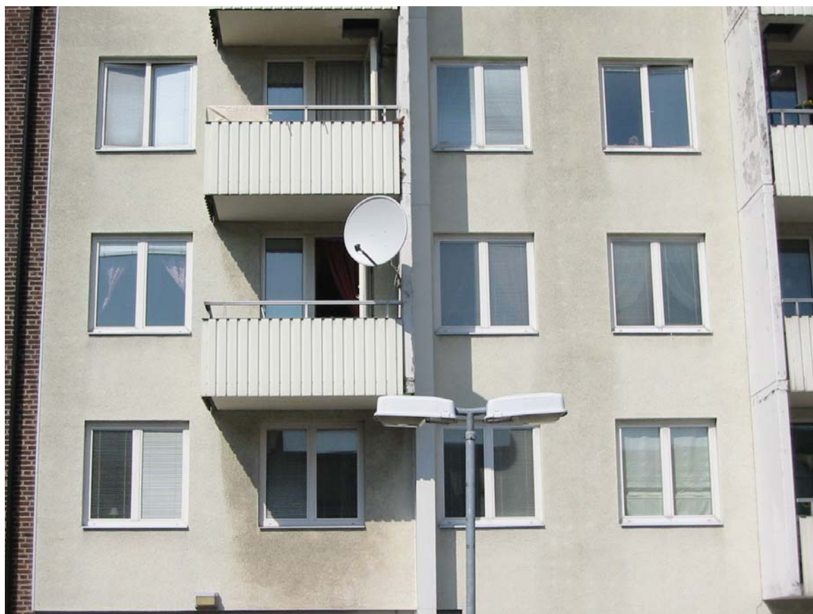
Figur 32. Angripen söderfasad (2) på AG-huset. Påväxt mellan fönster och under balkong.
