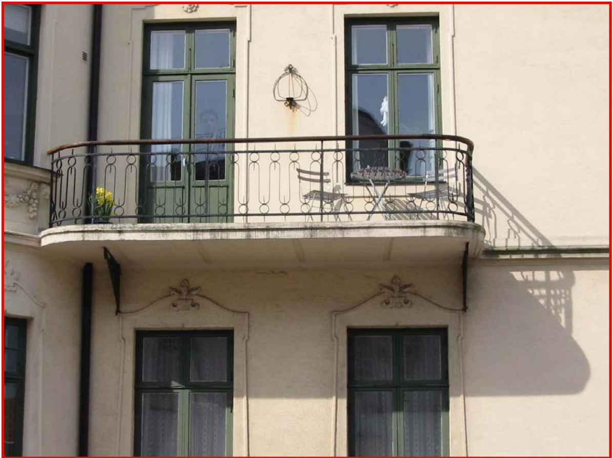
Figur 46. Påväxt på balkongkant
