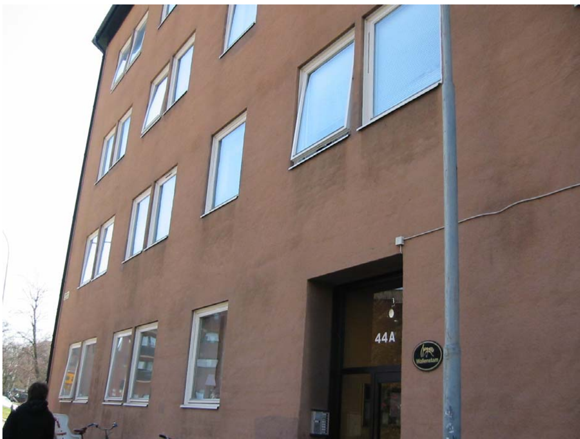
Figur 20. Missfärgning på putsfasad, främst under fönster.
