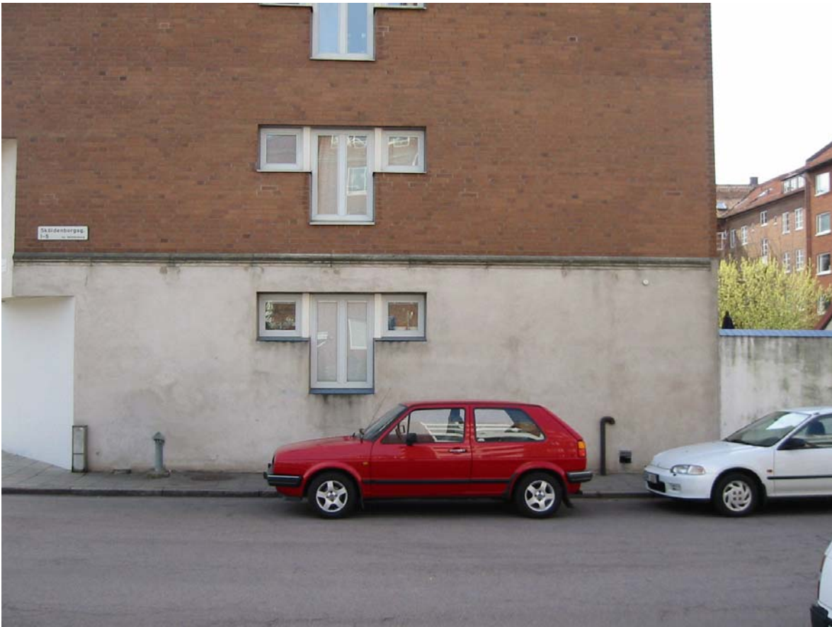
Figur 54. Angripen fastighet på Sköldenborgsgatan 1.
