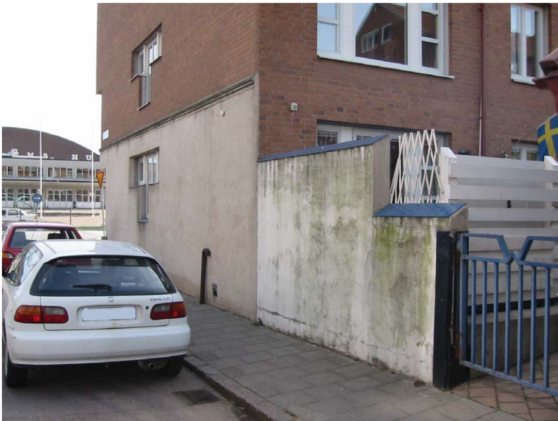
Figur 56. Angripen mur på Sköldenborgsgatan 1.
