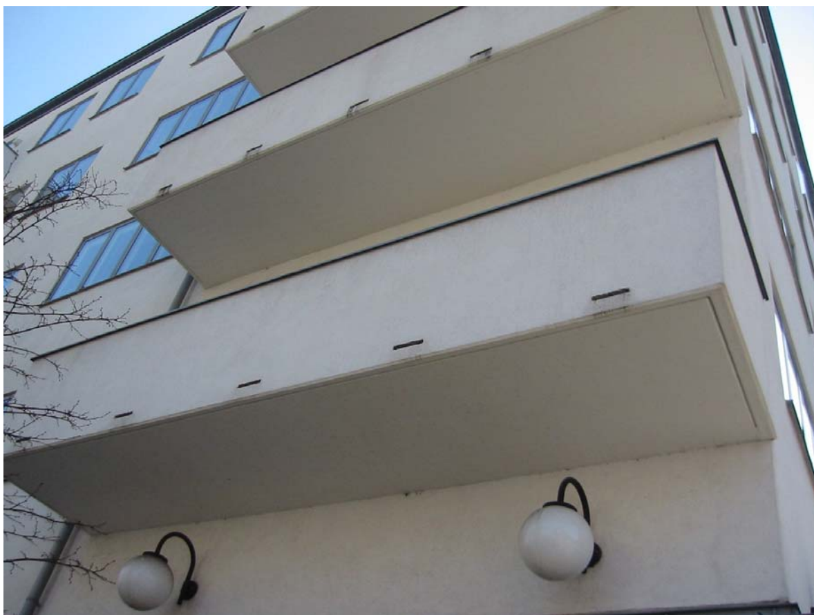
Figur 17. Balkonger i norrläge med tydlig effekt av vattenavrinning.
