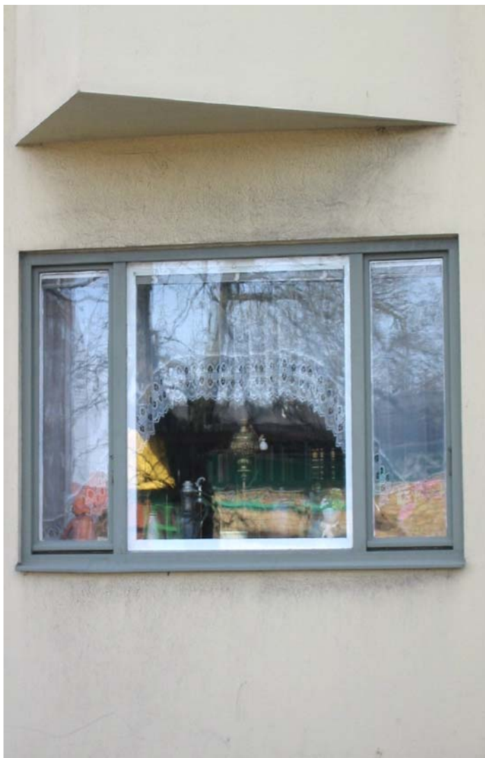
Figur 40. Missfärgning under fönster och burspråk.
