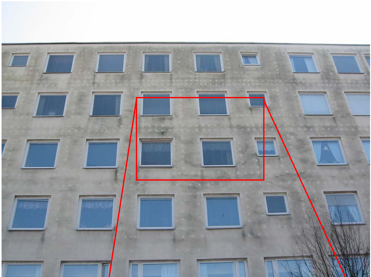
Figur 30. (Ovan) Angripen norrfasad (4) på AG-huset.
