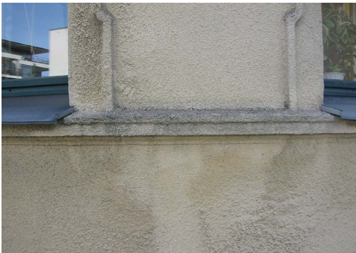
Figur 44. Angripen kant mellan två fönsterbleck.
