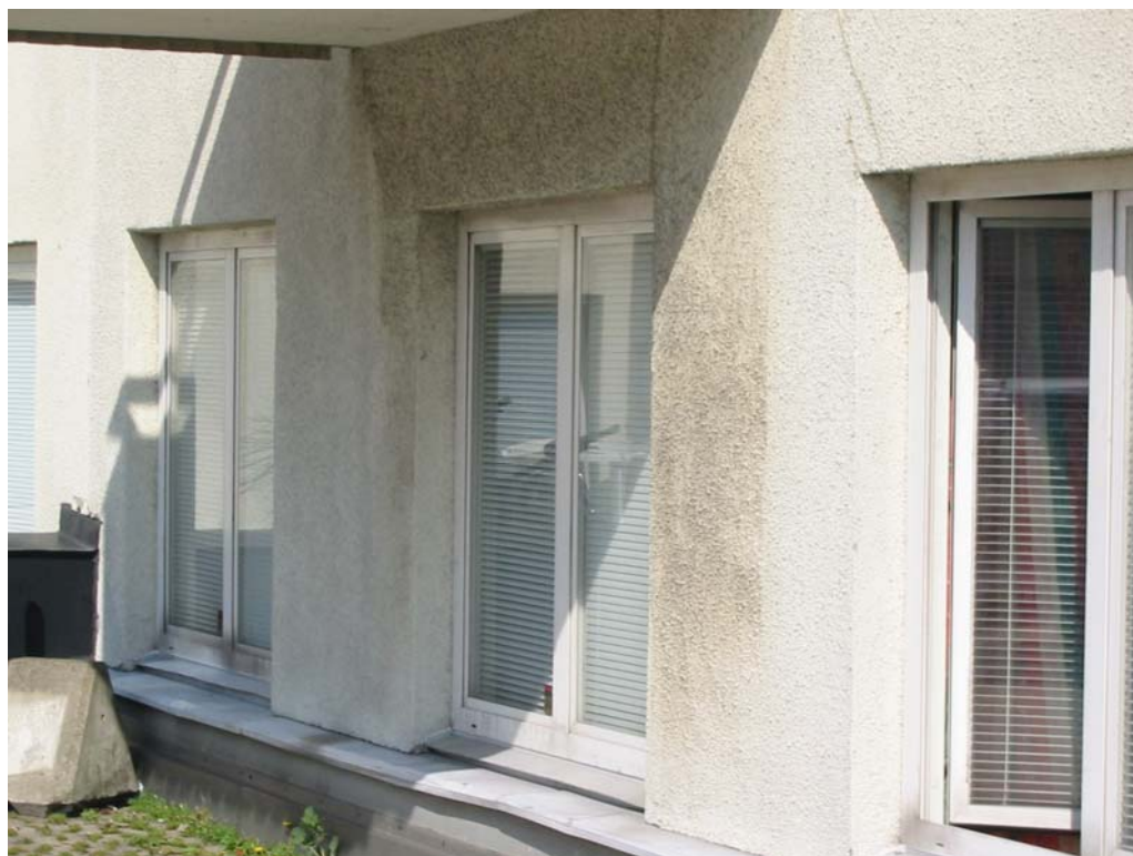
Figur 33. Påväxt under balkonger på västfasad (1) på AG-huset.
