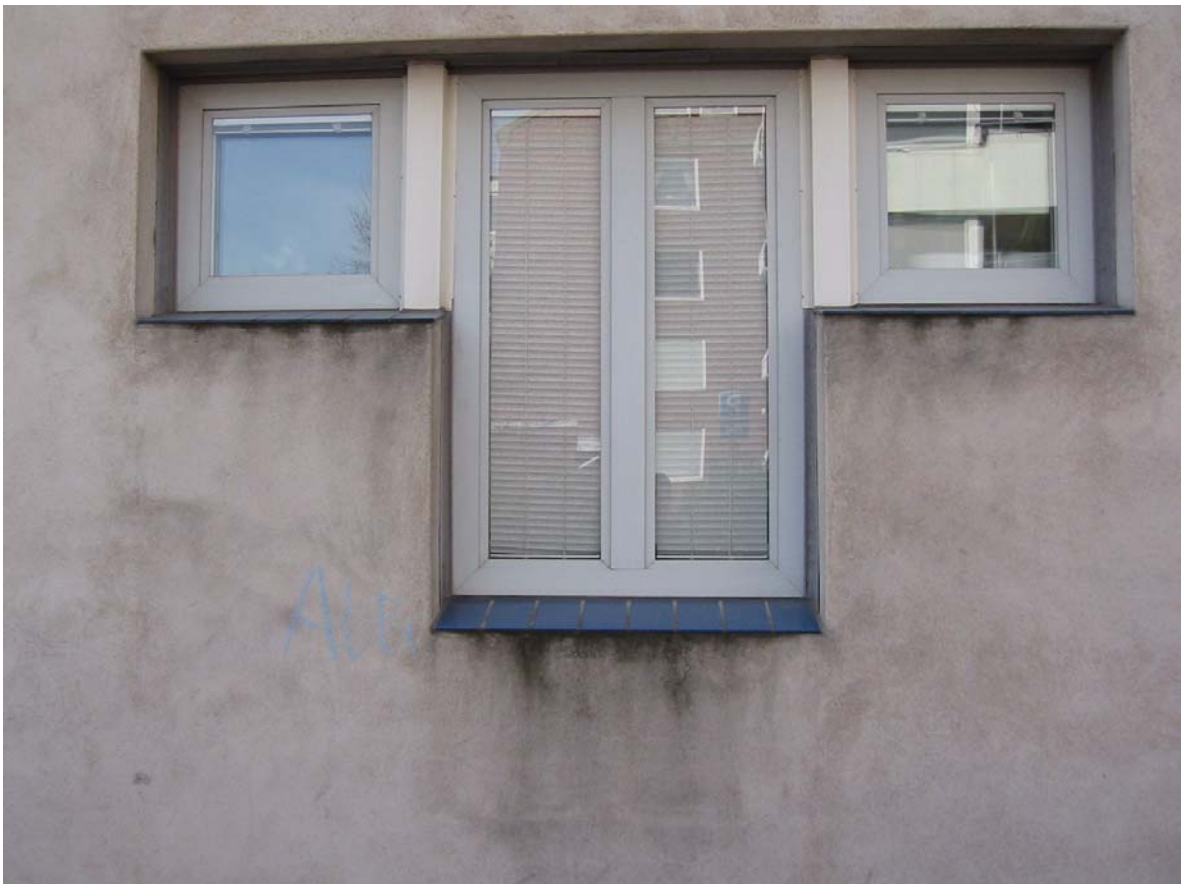
Figur 55. Tydlig påväxt på fuktiga partier under fönster.
