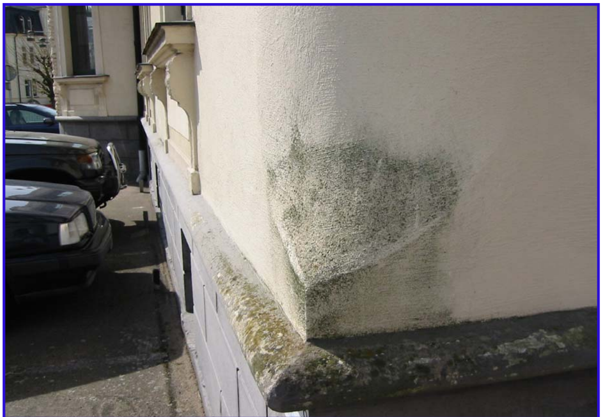
Figur 47. Märklig påväxt vid hörn på fastigheten.
