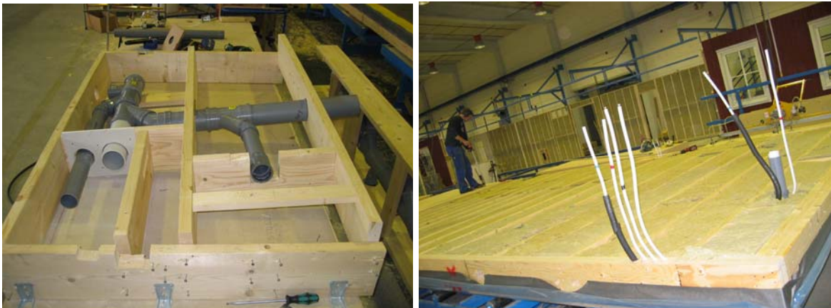
Bild 21 & 22. Avloppsgroda och Golvbjälklag
