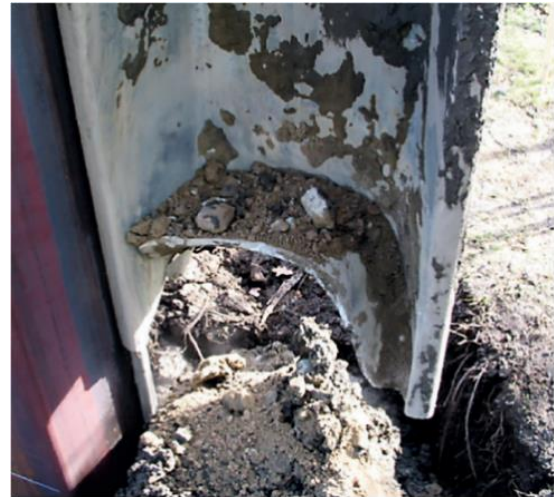
Figur 2: Exempel på skadad spontplanka. Foto: K. Viking.
